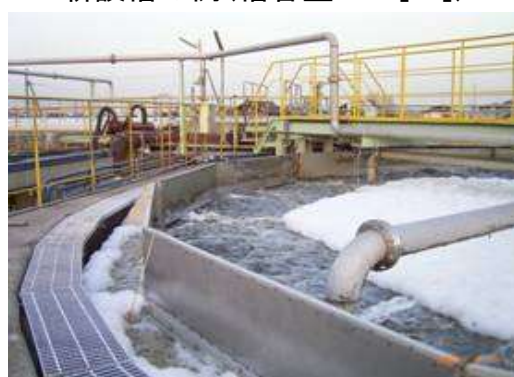
既設沈降槽を改造した例(槽容量:570[m 3 ])
